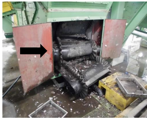
焼損・脱落したベルト
