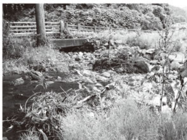
水路が埋まっている箇所
