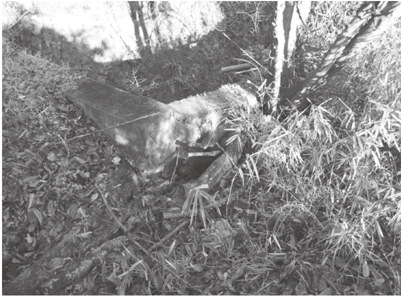
補修が急がれる洞巖山隧道周辺
