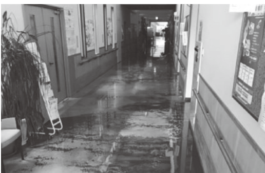
高齢者福祉複合施設ゆうらいふの被災状況 施設の全館が床上浸水しました
