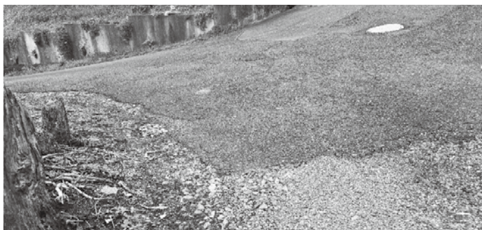
補修工事が待たれる道路
