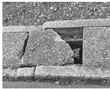
破損した溝ぶた
